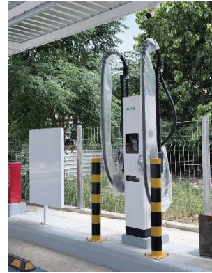
道通泰国高功率充电站项目
