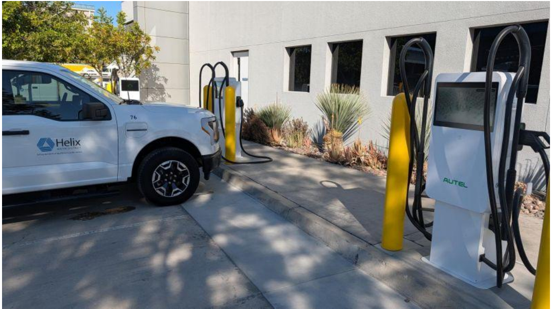
道通加州赫利克斯大型电动车队充电枢纽项目
