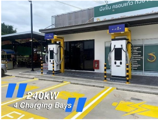
道通泰国高功率充电站项目
