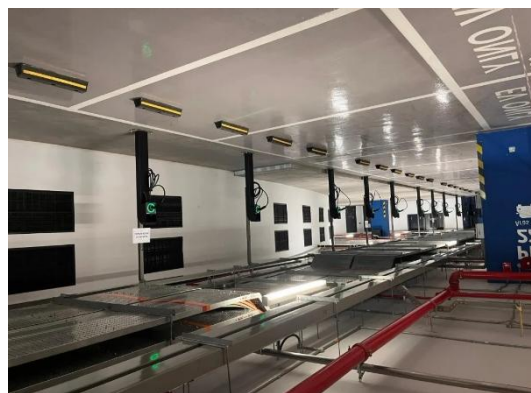
道通马来西亚大型交流充电站项目
