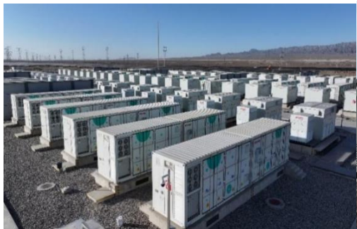
甘肃嘉峪关储能项目
