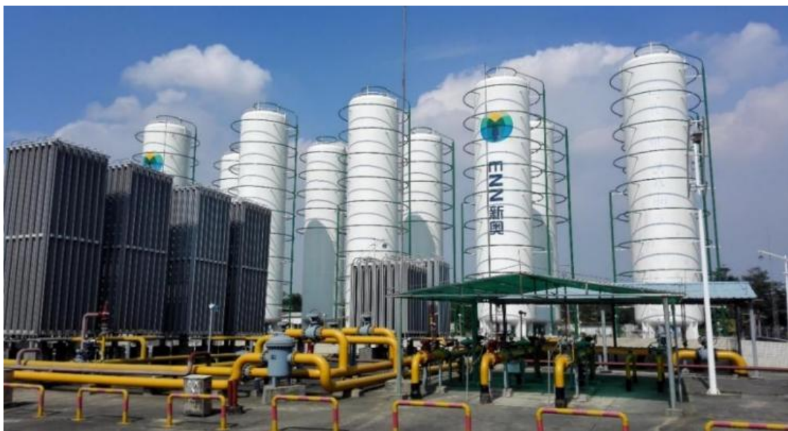
公司天然气厂站
