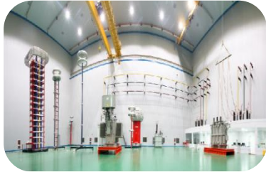
变压器综合测试系统
