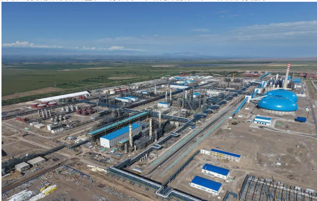
伊泰伊犁 100 万吨/年煤制油项目
